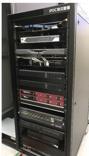
社内に設置された IPDC 防災装置
